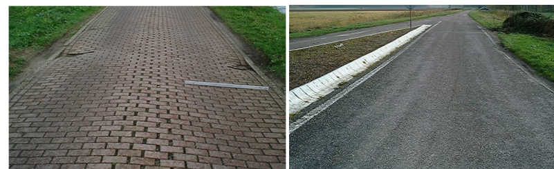
Figuur 2 Schades dwarsonvlakheid en rafeling
